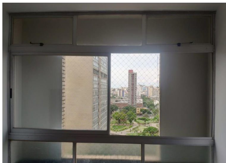
Janela em alumínio, de tipo 1, instalada atrás das fitas horizontais do bloco “A” em substituição à janela original, J2, Fotografia: Sergio Hirle de Souza, 2021.
