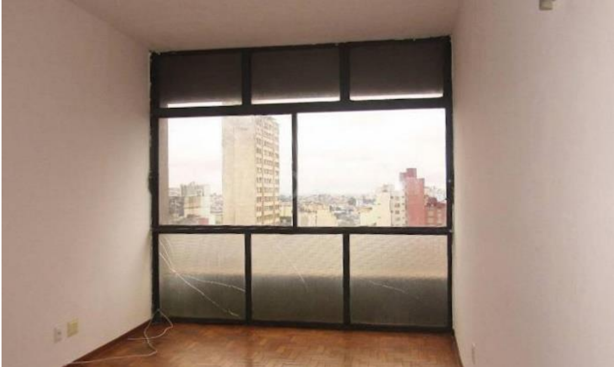
Janela em metalon original, tipo 1, no bloco “A”, instalada recuada em relação ao plano da fachada. Com o recuo da janela nesse pavimento, Niemeyer criou o rasgo horizontal na fachada. Notar a sombra da alvenaria na parte externa que reduz a altura da abertura. Autoria: não identificada.
